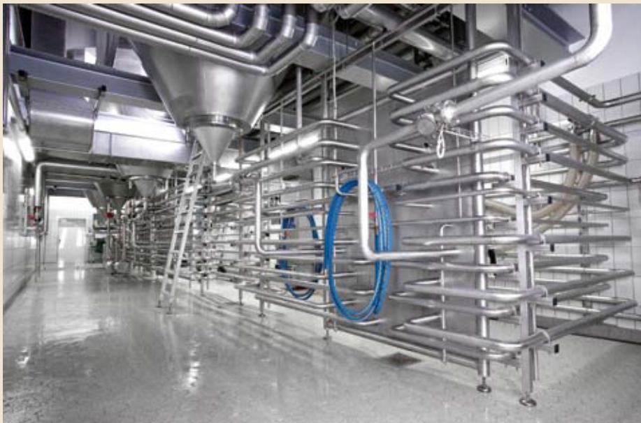
Um die neuen Tanks an alle kommunizierenden Gewerke und Versorgungsmedien anzubinden, musste ein neues Verrohrungskonzept erarbeitet werden
