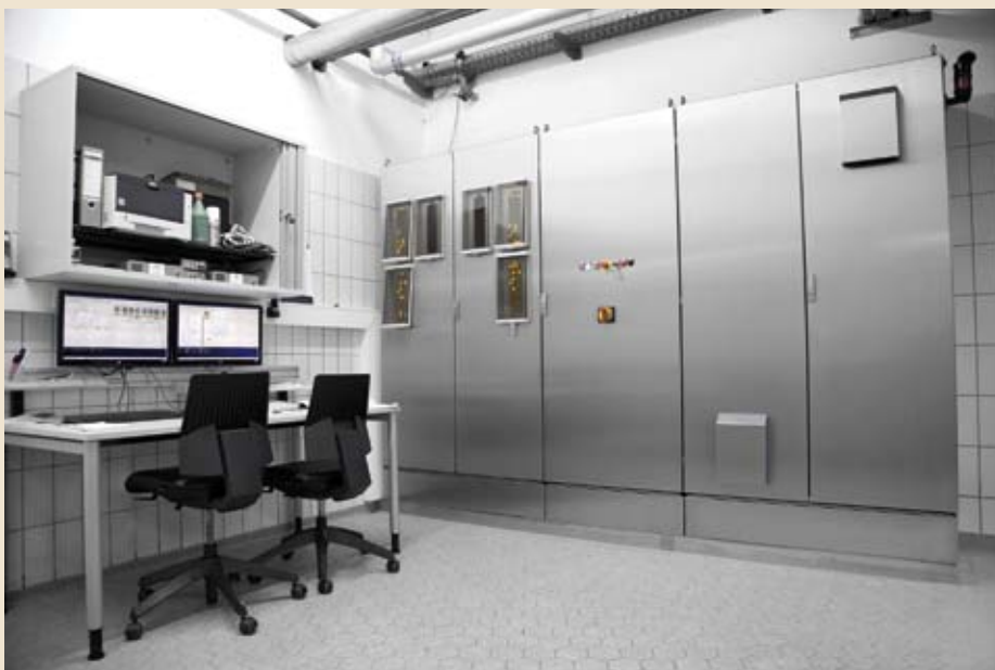
Steuerung und Schaltschränke wurden von der Brauerei selbst entwickelt, gebaut und verkabelt
